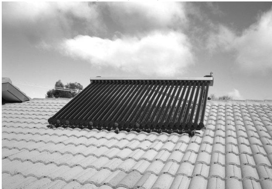
شکل ۲-۴- آبگرمکن خورشیدی: لوله‌های جمع آورنده خلاء
